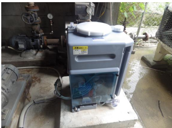
塩素を徐マンガン装置に注入している装置
